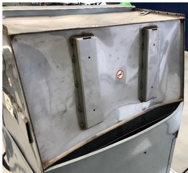
Abbildung 11: Beispiel für eine Verformung einer auf 0,5 kPa Restdruck entleerten Anlage, die dennoch gasdicht ist, Bildquelle: Westnetz
