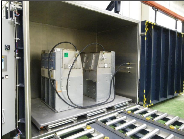
Abbildung 12: Beispiel für Rückgewinnung von SF 6 in einer Evakuierungskammer unter Verwendung eines gasdichten Bohrsystems, Bildquelle: Afesa
